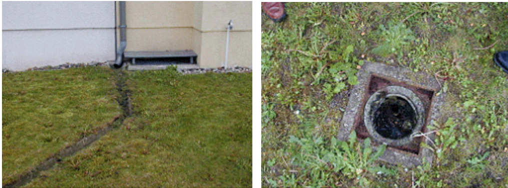
빗물 저류·침투 시설(빗물 드레인, 맨홀)
