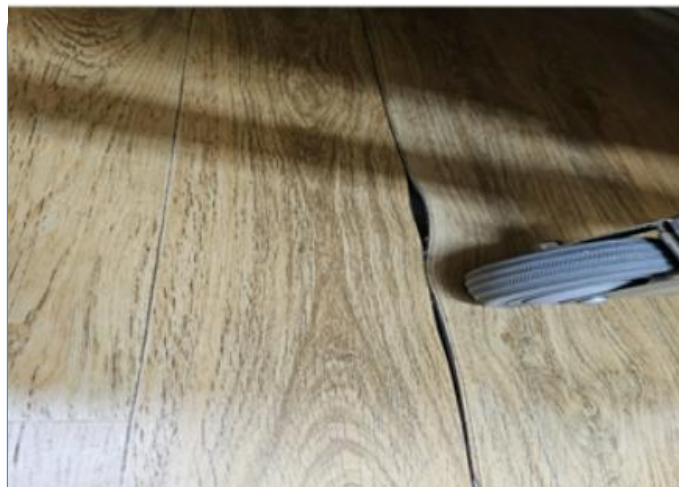
바닥 균열로 인해 끼임 및 낙상 위험이 있던 공간
