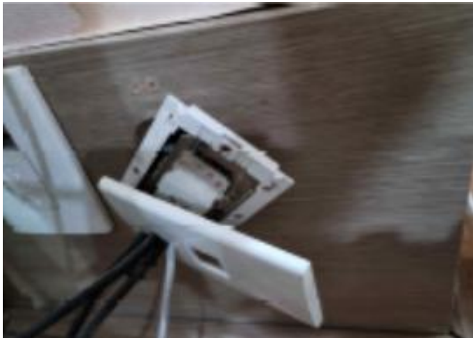
노후화 및 파손된 콘센트로 화재 위험이 있던 상황
