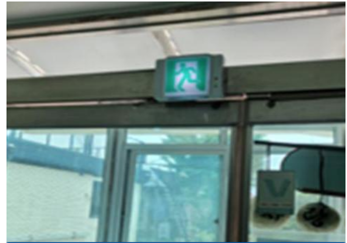
건전지 교체로 밝아진 비상구 유도등
