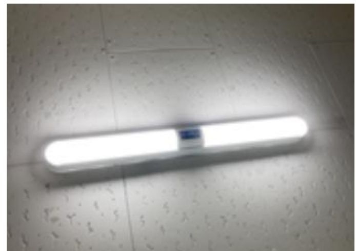
LED 등 설치로 조도가 개선되어 안전해진 환경
