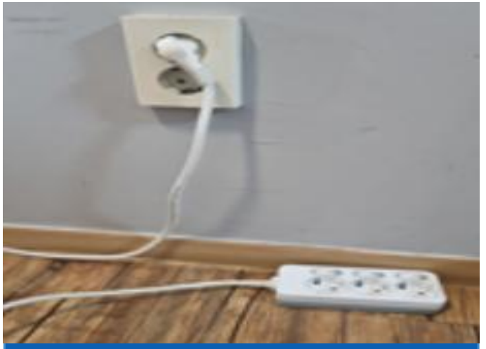
일반 멀티탭 바닥 방치로 화재 위험이 있던 상황
