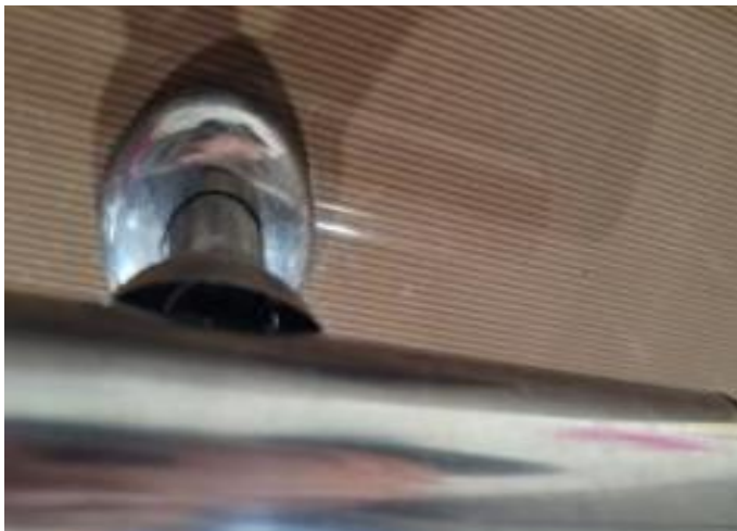
용접 부위가 날카로워 베이거나 찢릴 위험이 있던 안전바
