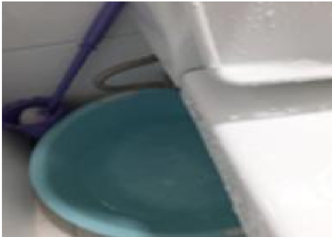
파손된 물탱크로 인해 누수 위험이 있던 변기
