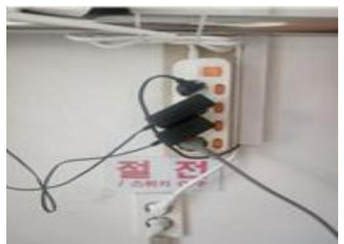
개별 차단 멀티탭 설치로 화재 위험성을 낮춤
