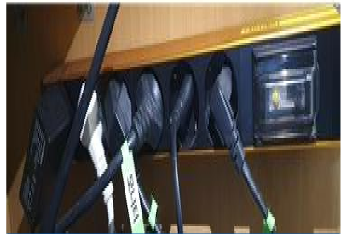
누전 차단 멀티 콘센트 설치로 안전해진 환경
