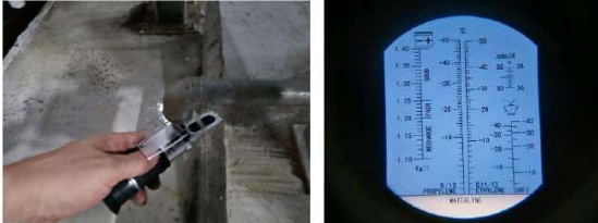
<지열원(브라인) 배관의 부동액 농도(어는 점) 측정 : 0°C>
