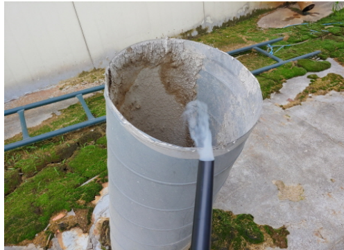
설치 불량 유입
