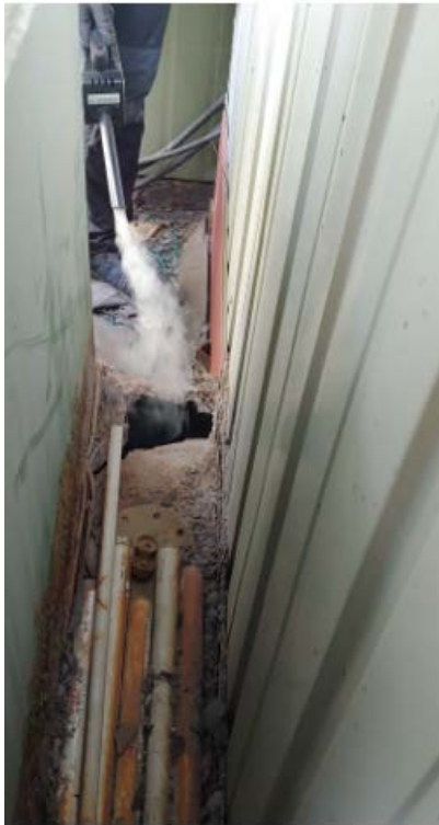
파손에 의한 유입
