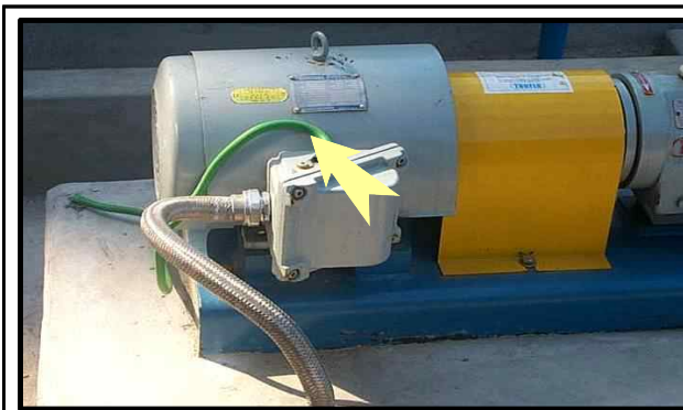
전기기계기구 구동모터 접지 ○
