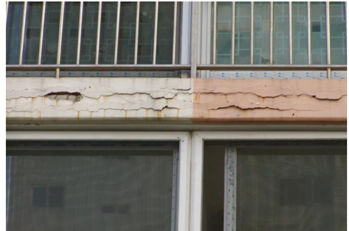
피복박락 및 철근 부식으로 인한 균열
