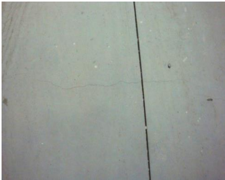
무근 콘크리트 균열
