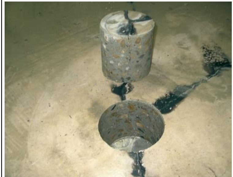
무근 콘크리트 균열(관통 균열)
