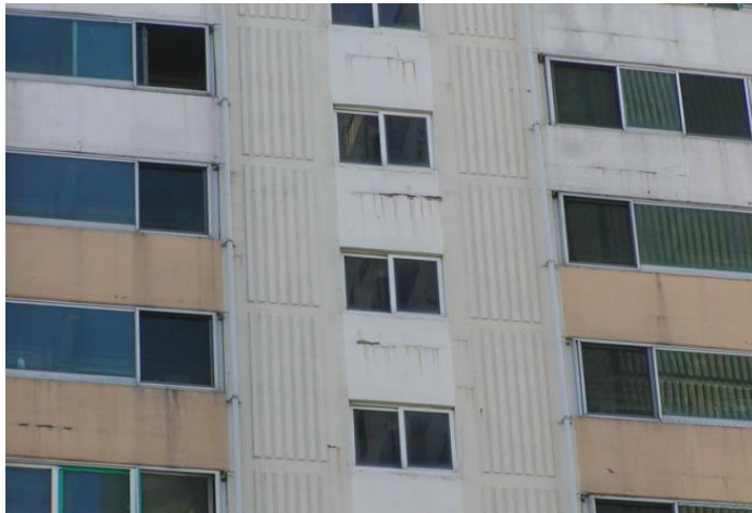
아파트 외벽 균열상태
