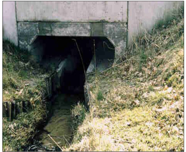
배수로 겸용의 상자형 파이프 암거. 양쪽에 동물이 이용할 수 있도록 선반 구조물 설치
